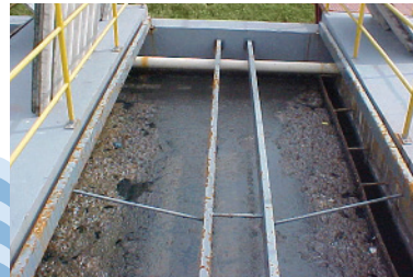
Estação de tratamento de esgoto
