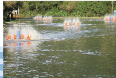
Estação de tratamento de esgoto
