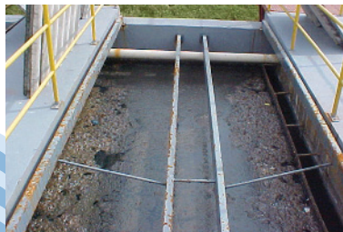
Estação de tratamento de esgoto
