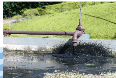
Estação de tratamento de esgoto
